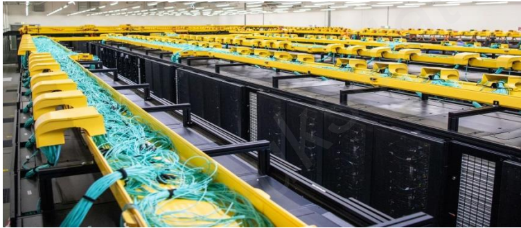
Şekil 3: Server’lerdeki kablo yoğunluğu
