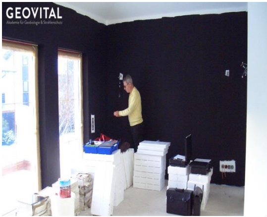
Resim 5: Almanya’da içten Mü malzemeyle kaplanmakta olan bir trafo
