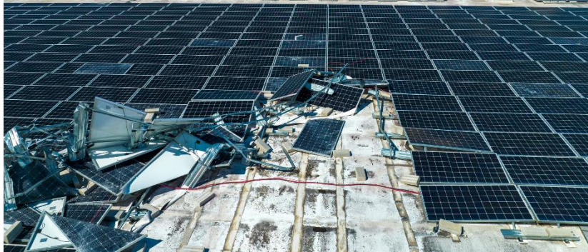
Düz bir çatıdaki fırtına nedeniyle hasar görmüş güneş panelleri.
